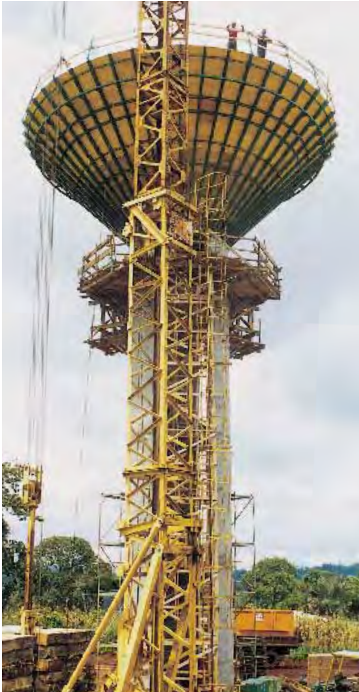
Errichtung eines Wasserturms in Bafoussam. Die Rehabilitierung und Erweiterung von Wasserversorgungseinrichtungen in fünf Orten Kameruns umfaßt den Bau von Wasserbehältern, Pumpstationen, das Verlegen von Rohrleitungen und die Installation von technischem Equipment (WIEMER & TRACHTE AG).
