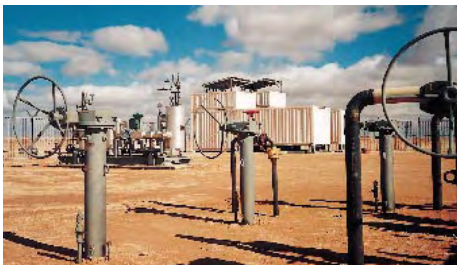
Die Firma Siemens AG erstellt Steuerungs- und Kommunikationseinrichtungen für das Teilstück der Erdgaspipeline von Algerien nach Spanien. Die Strecke verläuft an der libyschen Grenze von Al Rar nach El-Arischa (Grenze Marokko). Neben der Errichtung der Übertragungsstation wird auch die Schulung der Mitarbeiter übernommen.
