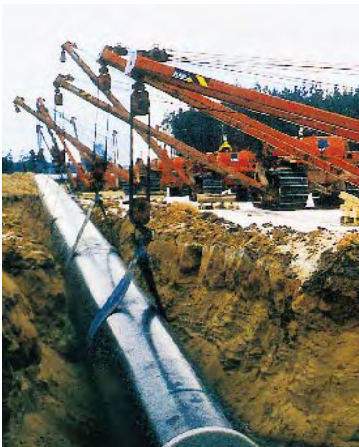
Im Rahmen des Euro-Yamal-Projektes werden neue Erdgasfelder auf der russischen Halbinsel Yamal erschlossen und durch den Bau der Pipeline an das deutsche Energienetz angeschlossen. Die Firma Mannesmann liefert die Großrohre für diese Gaspipeline.
