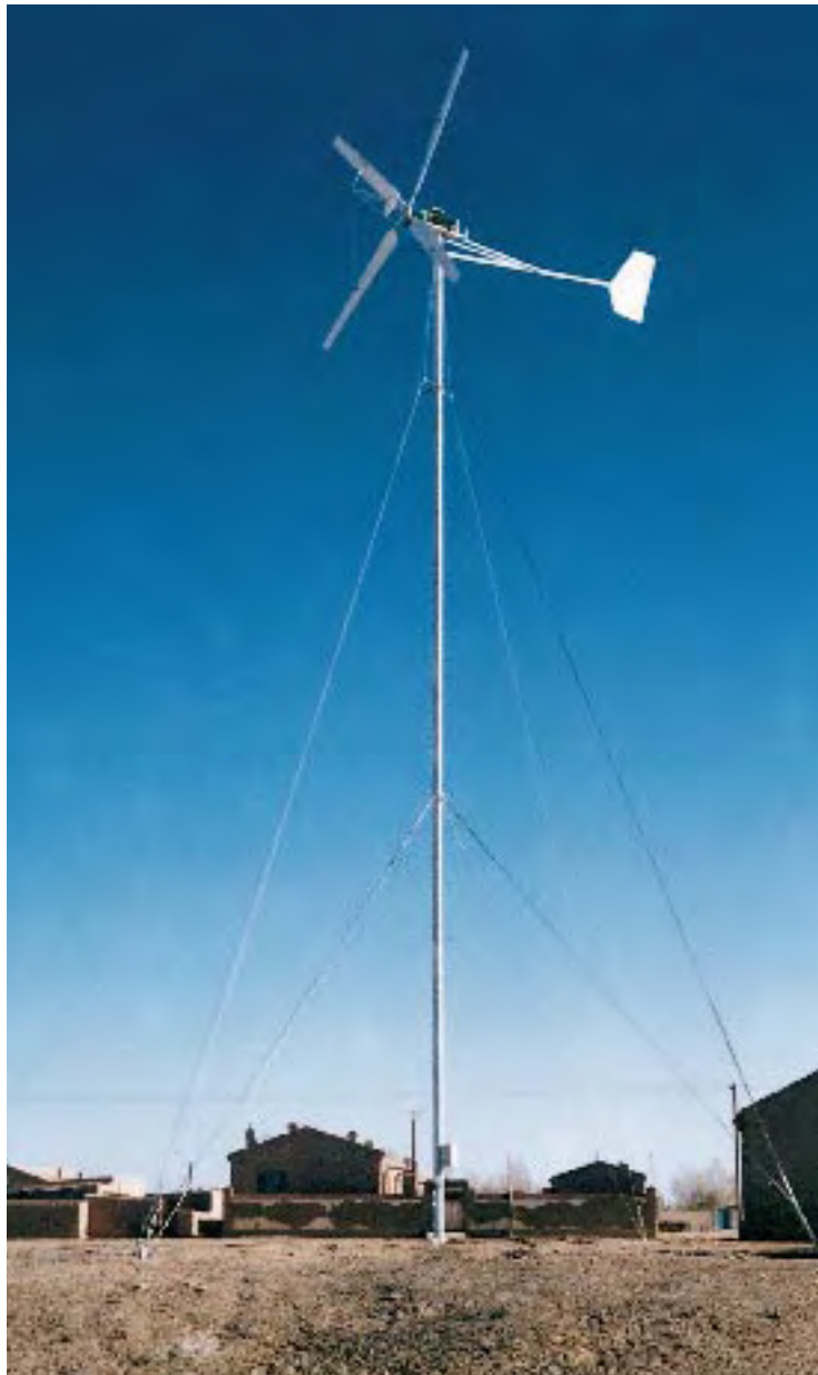
Windkraftanlagen der Firma WENUS Windenergie-Nutzungs-Systeme in der Inneren Mongolei/China. Die Anlagen werden dort im Rahmen der ländlichen Elektrifizierung zur Versorgung von Dörfern eingesetzt.
