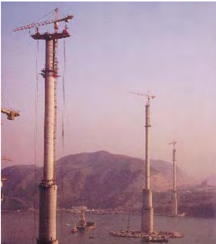
Die Ed. Züblin AG errichtete in Hongkong im Rahmen einer internationalen Arbeitsgemeinschaft eine Straßenbrücke mit einer Länge von 1.775 m, die die Insel Tsing Yi mit dem Festland verbindet. Nach einer Bauzeit von 3 3/4 Jahren wurde die Brücke im Mai 1998 für den Verkehr freigegeben.
