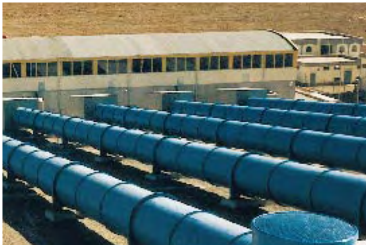
Im Rahmen eines Landwirtschaftsprojektes in Marokko rüstet die Firma KSB, Frankenthal, zusammen mit Partnern eine der größten Pumpstationen aus für die Bewässerung der Hochebene Abda Doukkala, ca. 100 km südwestlich von Casablanca.
